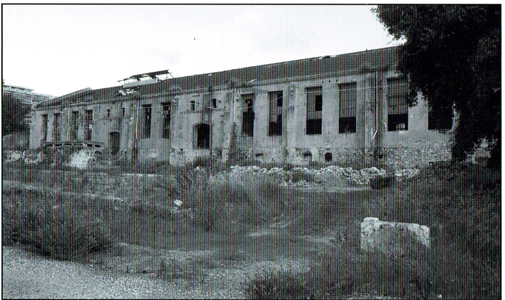
L'ex centrale elettrica in stato di totale abbandono
